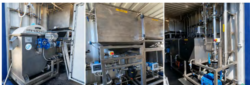
Figura 4: Vista interna del container DEMO 2 installato presso La Torre: da sinistra, sistema PRIMESCREEN® per la separazione preliminare solido-liquido del digestato, serbatoi di alimentazione e accumulo, e sezione di ultrafiltrazione per il trattamento della frazione liquida.
