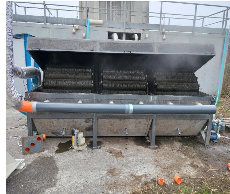
Reattore di strippaggio con elevata superficie di contatto
