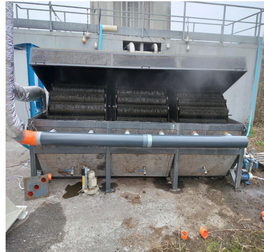
Reattore di strippaggio con elevata superficie di contatto
